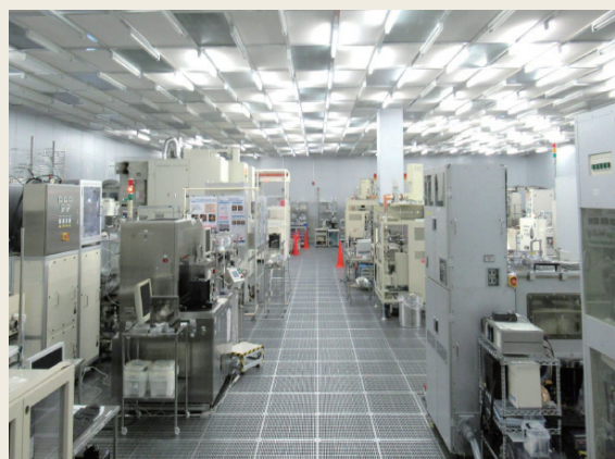
クリーンルームおよび装置の様子
